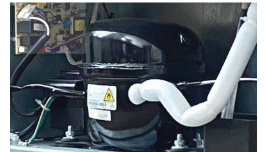
コンプレッサー
